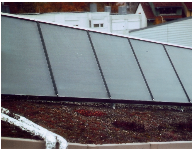
Abbildung 6: (Thermische) Solarkollektoren auf Vegetationsdach.
